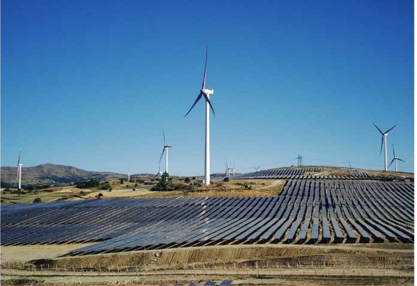
Uşak RES Hibrit GES Santrali
